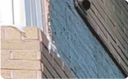
단열재, 벽돌 타일 탈락하자 사례
